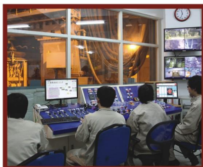
Phòng điều khiển Controlling system room
